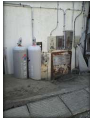
布佐都地区 地盤沈下の様子
